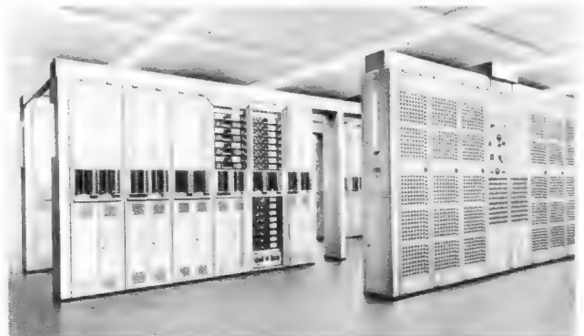
Bild 2. Tonleitungs-Verstärkereinrichtungen mit abgesetzter großer Schaltanlage nach dem Entwicklungsstand von 1954 (Frankfurt a. M.)
